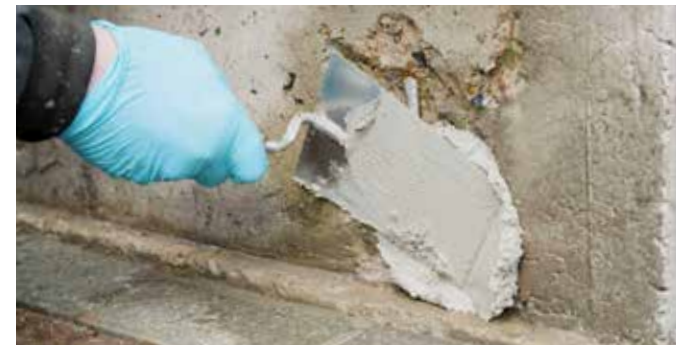
4 KÖSTER Betomor Multi A wird mit Spachtel oder Traufel in einem Arbeitsgang aufgezogen.
